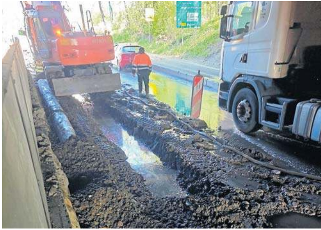
Drogowcy natrafili m.in. na stalowy rurociąg, którego nie było na mapach i to opóźniło prace
