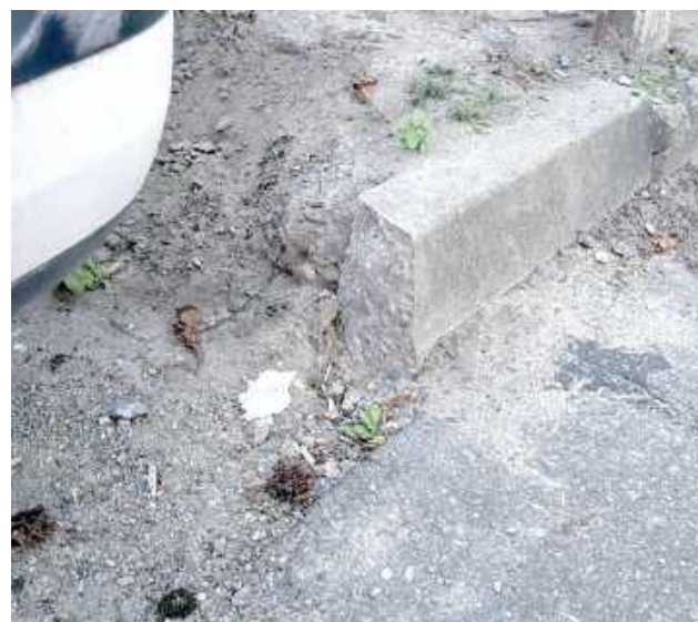
Krawężnik nie dodawał temu miejscu walorów estetycznych...
