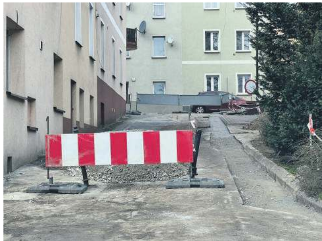
Gmina Trzebnica zleciła naprawę ulicy Wąskiej, a Spółdzielnia Mieszkaniowa wskazuje, że słupki zamontowane przez gminę, zostały postawione nielegalnie
