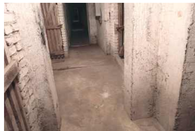
Piwnica w bloku przy ul. Lipowej 1 A zawiłgocona po deszczu, kilka dni po opadzie czuć jeszcze odór studzienki
