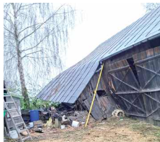
Uszkodzona przez silny wiatr stara stodoła
