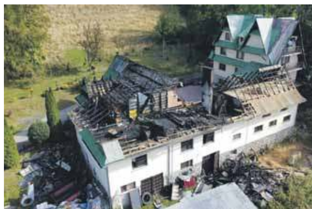
Tak wyglądają zabudowania tuż po akcji gaśniczej.
