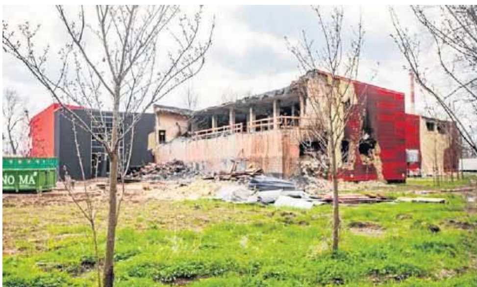
Grzyby znajdują się głównie w dolnych magazynach, do których dostęp jest utrudniony
