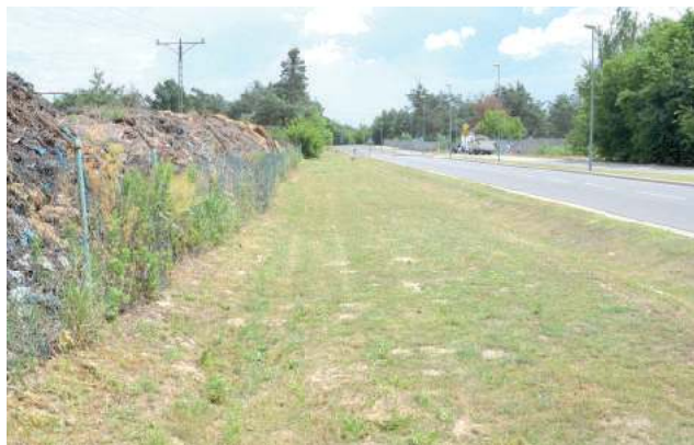
Granica kompostowni od strony południowej – Rozporządzenie nakazuje wydzielenie 10 metrowego pasa zieleni, a tutaj niczego takiego nie ma. Jedynym ogrodzeniem kompostowni jest zardzewiała siatka, która nie jest żadną barierą – mówi mieszkaniec Puław.
