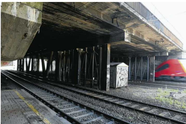
• Wiadukt na ulicy Towarowej jest w fatalnym stanie technicznym
