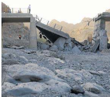
W wyniku amerykańskich ataków został m.in. uszkodzony most w południowym Iranie
