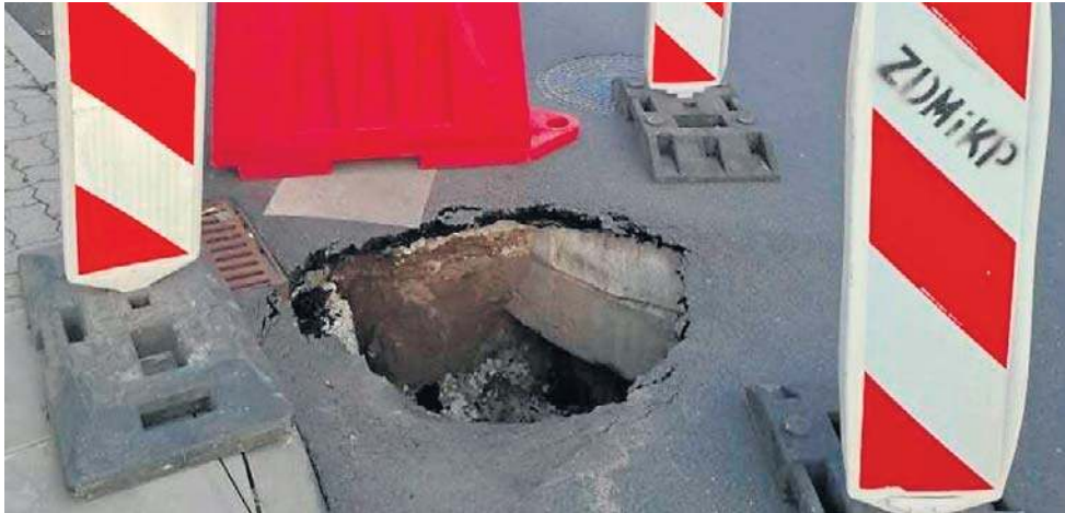
Wielka dziura na rogu ulic Nowodworskiej i Podgórnej. To efekt deszczu nawalnego, który uszkodził również pokrywę zbiornika retencyjnego na ul. Podgórnej
