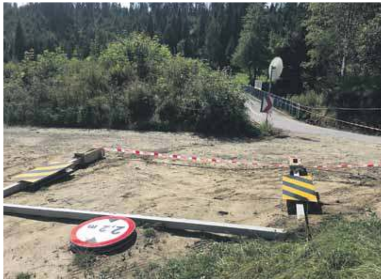
Zniszczone oznakowanie na moście w Pyzówce.
