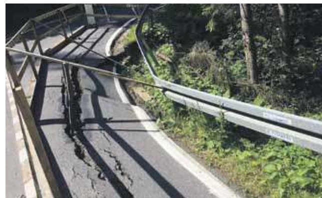
Zniszczona droga w Knurowie.
