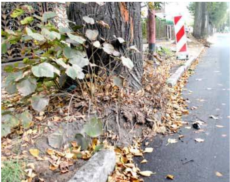
Na zdjęciu widać, że korzeń został odsłonięty. ZDP uspokaja, że nie stanowi to zagrożenia
