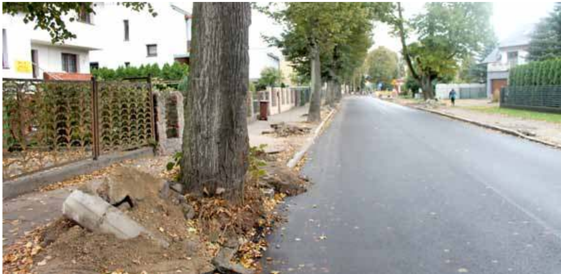
Mieszkańcy sygnalizują, że w wyniku zerwania części kostki brukowej a także prac przeprowadzonych na jezdni mogło dojść do naruszenia trwałości korzeni lip
