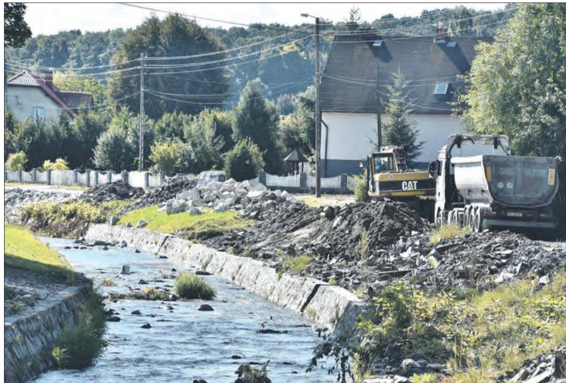
Duża część inwestycji Powiatu Prudnickiego będzie dotyczyła odbudowy infrastruktury drogowej i mostowej zniszczonej przez powódź
