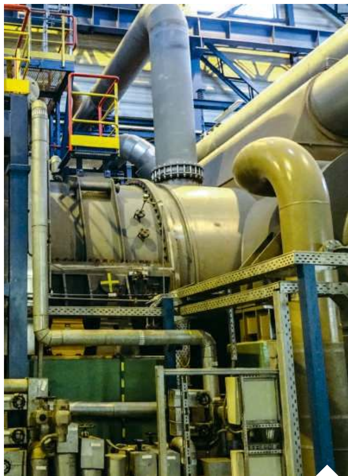
Polska Grupa Energetyczna zainwestowała w Szczecinie ponad 600 mln zł w bardzo ekologiczne źródła energii. Modernizacja Ciepłowni Rejonowej „Dąbska” byłaby w tej sytuacji nieekonomiczna | fot. mat. pras./d
