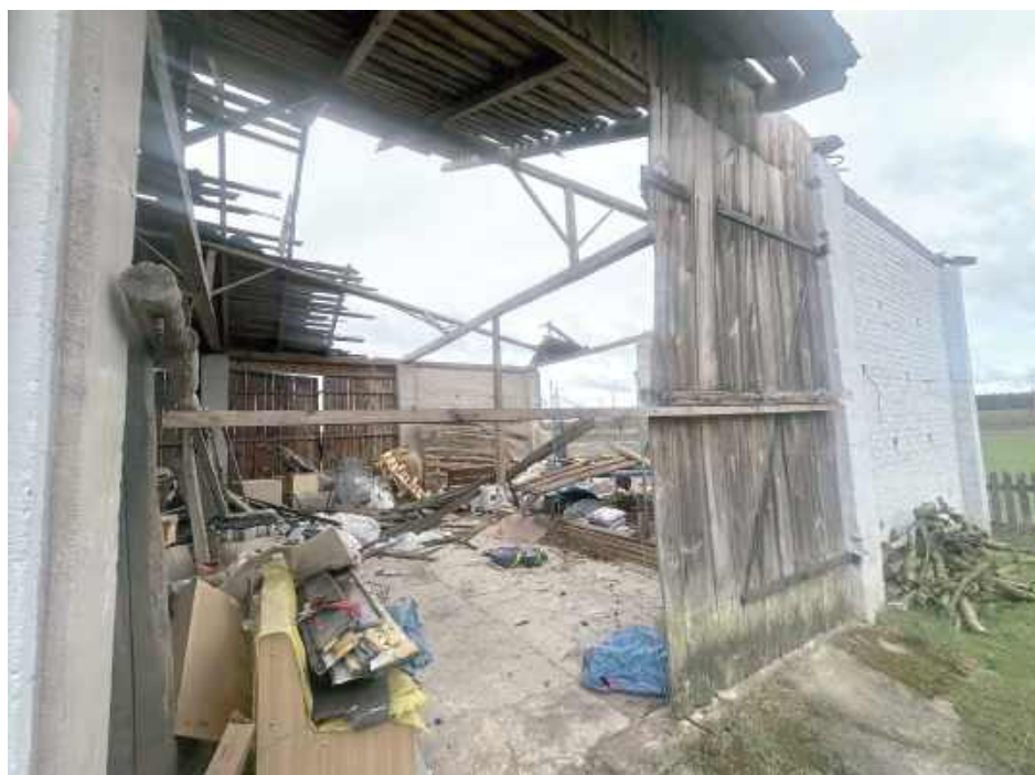
W Koronie uszkodzona została stodoła
