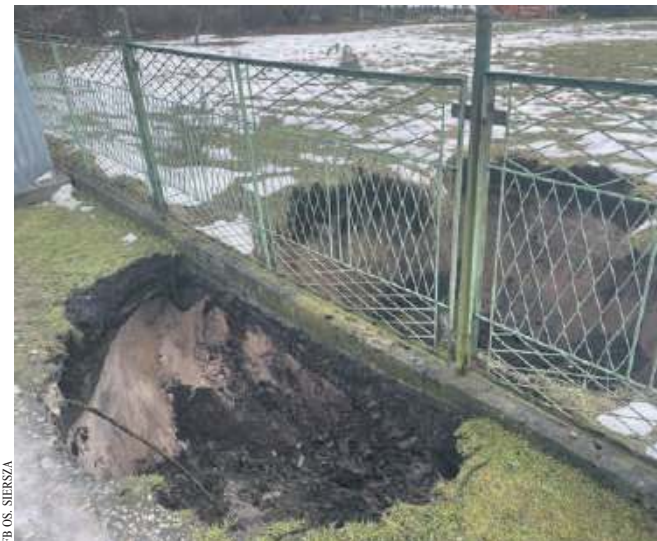
25 grudnia 2022 r. - zapadła się ziemia w pobliżu domu na ul. Górniczej
