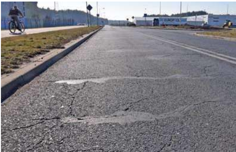
Ul. Przemysłowa zdecydowanie zasługuje na remont (fot. Anna Chyła/sta-rostwo powiatowe)
