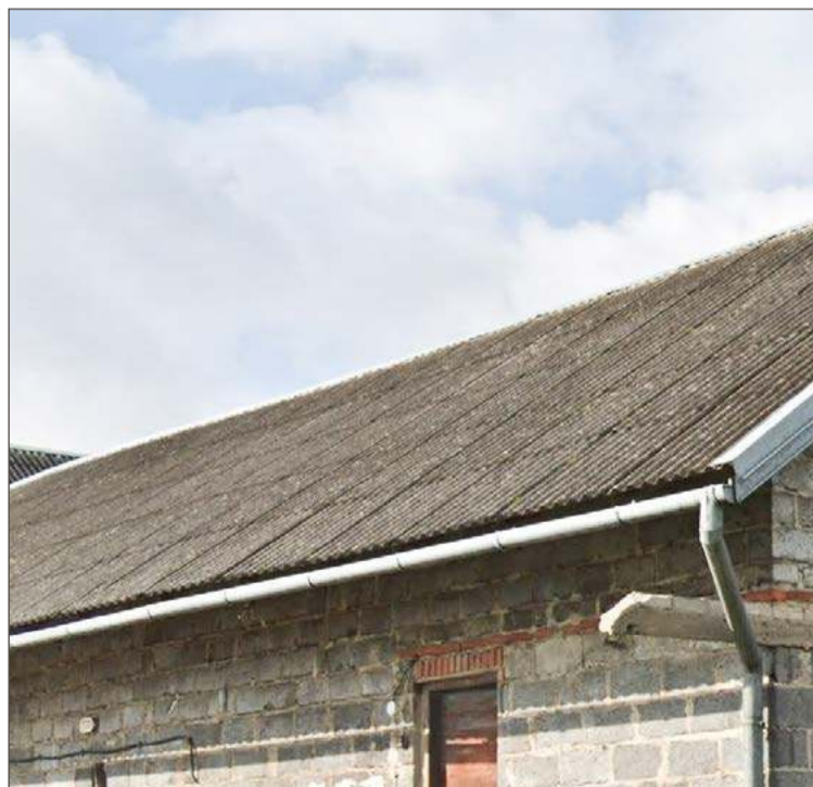
W gminie Jodłowa wciąż nie brakuje budynków, na których znajduje się eternit.
