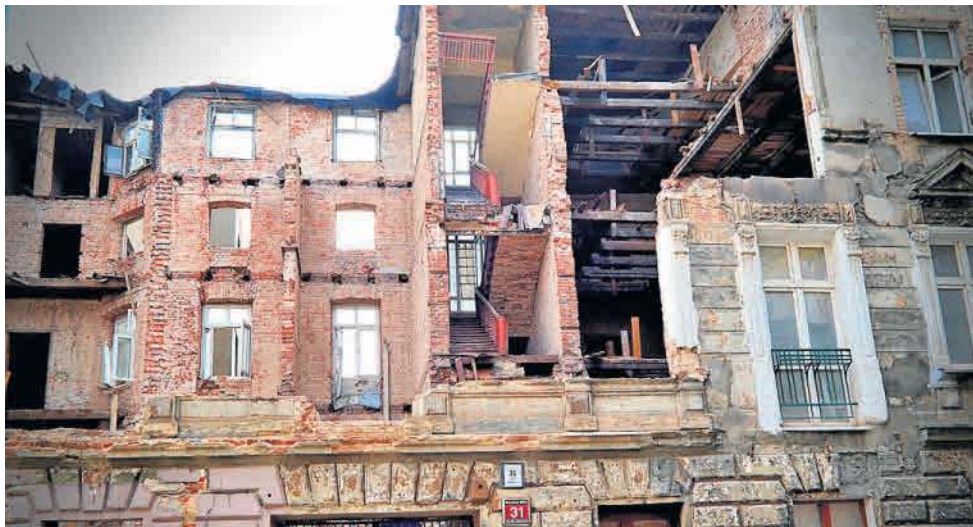
Łódzkie kamienice są w złym stanie. Politycy zaczęli szukać rozwiązań, aby budynki nie zawaliły się
