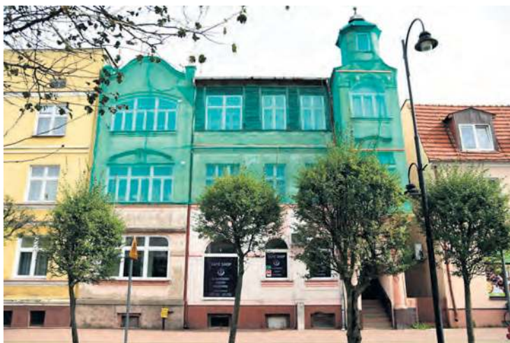
Kamienica przy ul. Świeckiej została zabezpieczona na ewentualność odłamującego się tynku.
