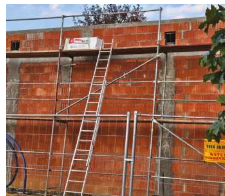
Fot. 1. Rusztowanie błędnie zmontowane – m.in. nieprawidłowy pion komunikacyjny, złe wykonane stężenia, niekompletne balustrady
