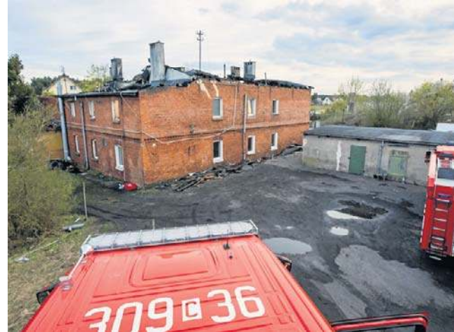
Budynek przy ulicy Łochowskiej w Bydgoszczy po pożarze
