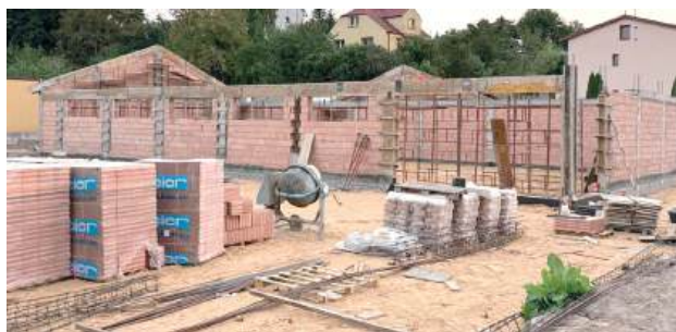
Zakończenie budowy przewiduje się na styczeń 2026 r. To będzie szósty market tej sieci w powiecie puławskim, a drugi w Gminie Puławy (po Bronowicach)
