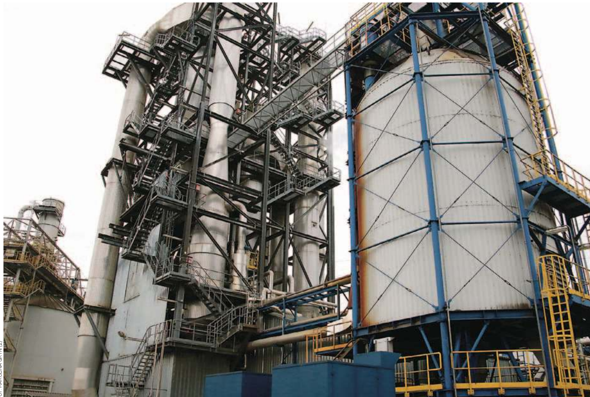
Oprócz zamykanych bloków węglowych, w ESW działa także kocioł na biomasę i będzie on wykorzystywany dalej jako jednostka zapasowa nowego bloku parowo-gazowego
