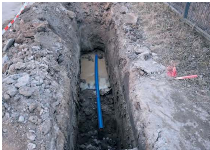
Gminie zostało dokończenie pozostałej części zadania, tj. montaż systemu monitoringu oraz wodomierzy. Fot. Gmina Lubiewo
