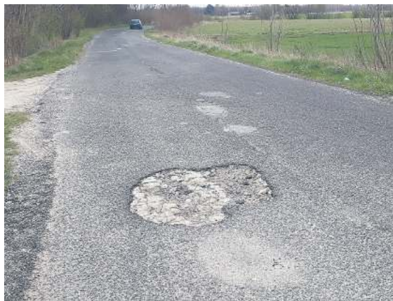
Fragment gminnej drogi w Łukówku Kolonii już wymaga naprawy
