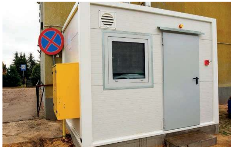
Kontener dla nowych kotłów gazowych
