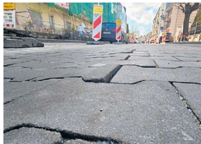
Nawierzchnia w niektórych miejscach się zapadła, tworząc doły, dlatego naprawa odbywa się w ramach gwarancji po wcześniejszym remoncie
