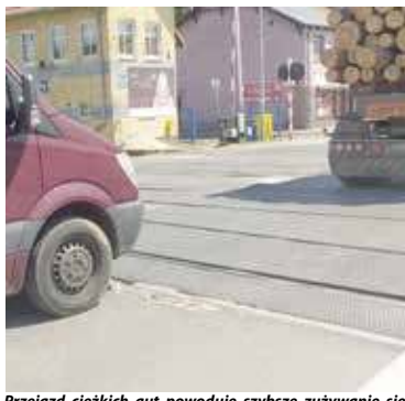
Przejazd ciężkich aut powoduje szybsze zużycie się nawierzchni
