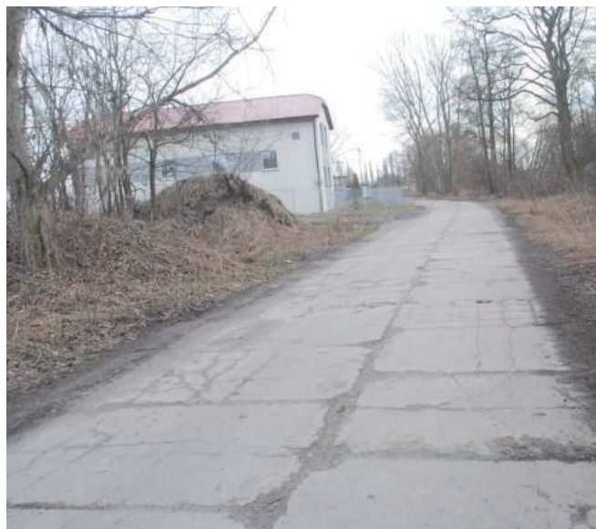
Odcinek od siedziby PGK do ul. Wierzbowej wymaga remontu. W tym roku miasto jednak nie ma środków na ten cel
