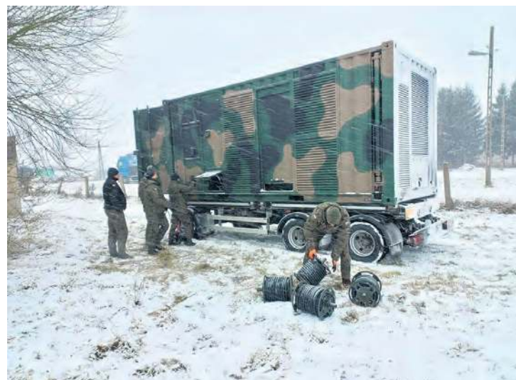
W Bysławiu działała 1/3 zestawu kontenerowej elektrowni KEP-900.
