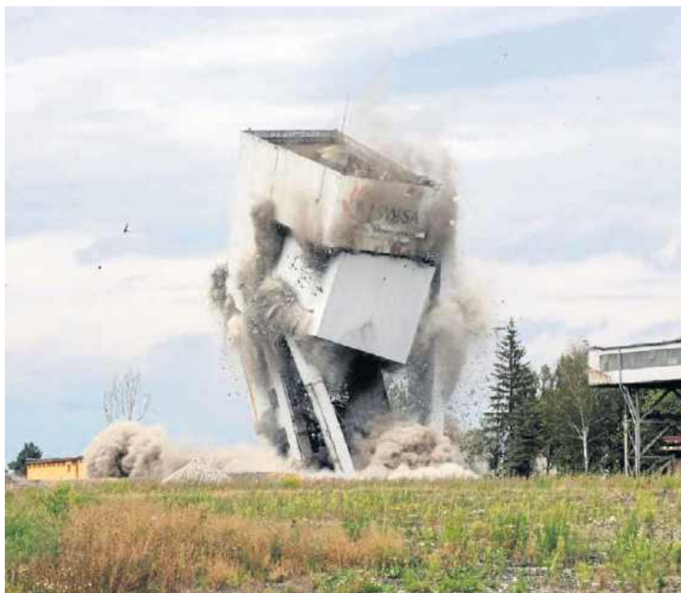
W Jastrzębiu - Zdroju runęła wieża mająca 73 m wysokości. Powstała pod koniec lat 60.
