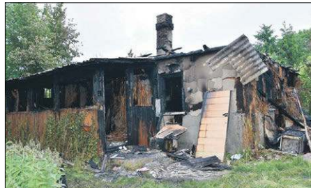
Najpierw był pożar drewnianego domu. Potem okazało się, że to podpalenie. A na koniec wyszło, że dom podpaliła była partnerka właściciela budynku
