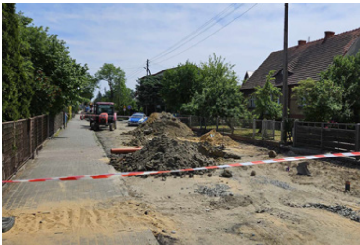
Strefa niebezpieczna zabezpieczona taśmą.
