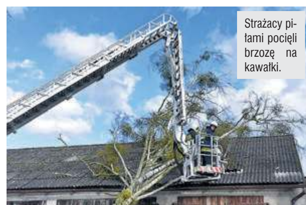
Wyjazd do uszkodzonego budynku pod Łęgiem był w czwartek jednym z pierwszych.
