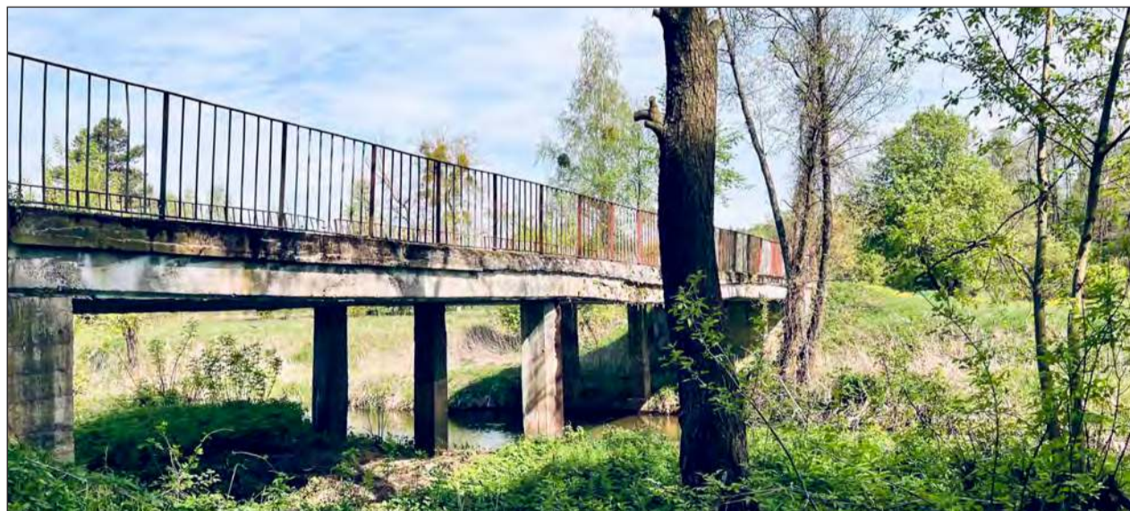
Gmina Trojanów zrobiła pierwszy krok w stronę przebudowy mostu na rzece Okrzejce w Jabłonowcu. 24 kwietnia podpisano umowę na opracowanie dokumentacji projektowej
