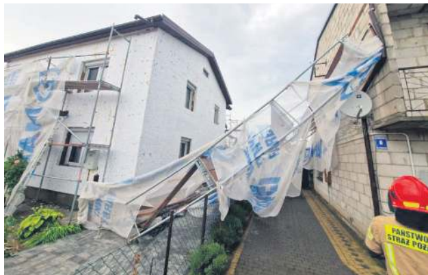
Przy ul. Parkowej w Łabuniach silny podmuch wiatru przewrócił na sąsiedni budynek rusztowanie budowlane.
