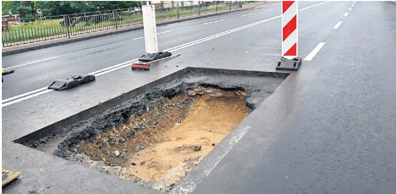
Na szczęście żaden z pojazdów nie wpadł do dziury w jezdni
