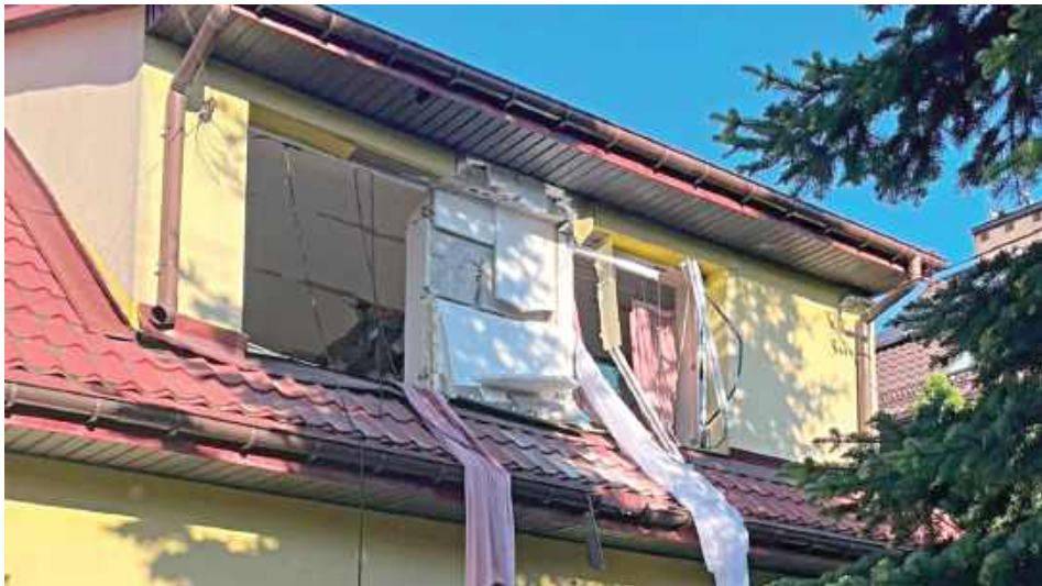
Zniszczony budynek jest domem rodzinnym Roberta, druha Ochotniczej Straży Pożarnej w Gocławiu
