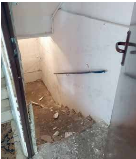
Zdemolowane wejście do piwnicy w klatce schodowej
