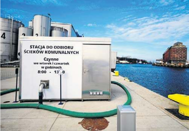
Nowoczesna stacja odbioru ścieków komunalnych
