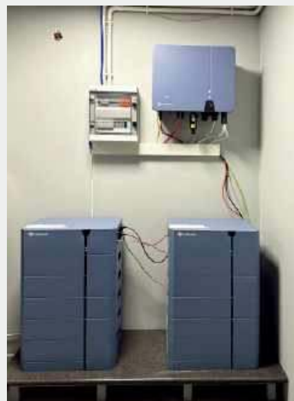
Instalacja hybrydowa Solplanet wykonana przez firmę DORIAN-ENERGIA
