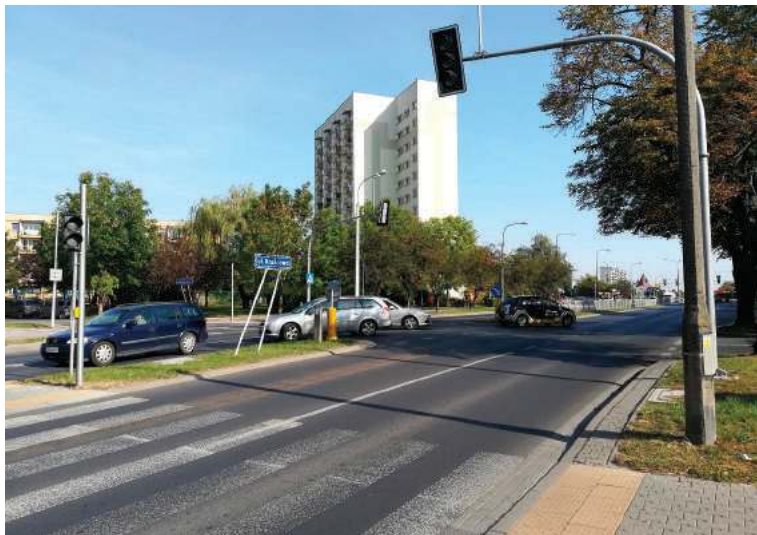
Zamontowana przed rokiem sygnalizacja wciąż nie działa
