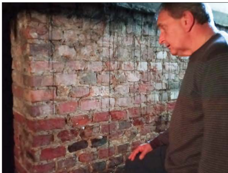
➤ Nawet po kilkunastu dniach po wypompowaniu wody, na ścianach piwnicy dobrze widać dokąd sięgał jej poziom. Krzysztof Kultys uważa, że ta wilgoć będzie przechodziła na wyższe kondygnacje
