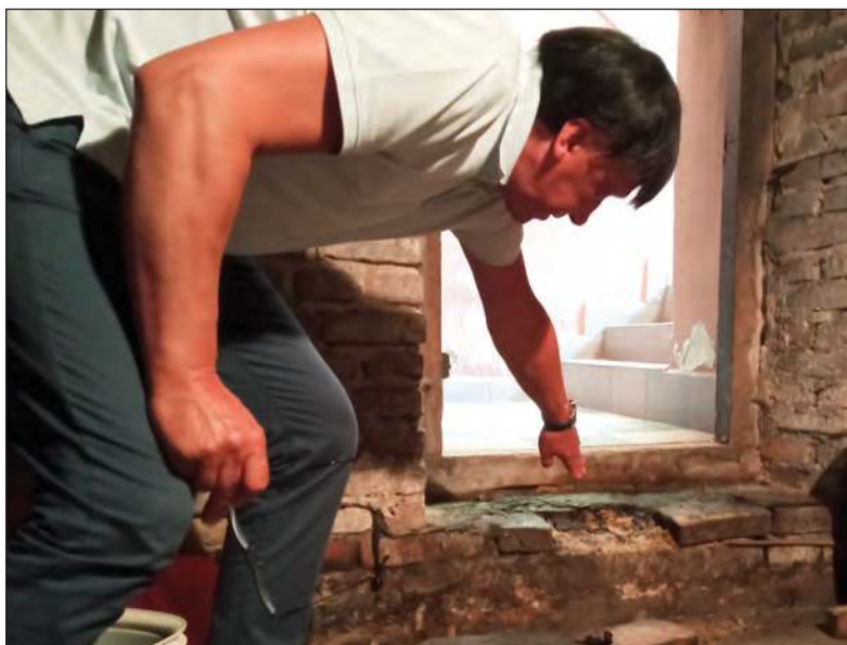
➤ Szkody wyrządzone przez wodę z łatwością dostrzega właściciel sklepu ogrodniczego przy ul. Poniatowskiego. - Przez wilgoć niektóre cegły mam powysadzane - zaznacza Krzysztof Domarecki
