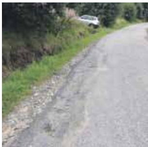
Woda po każdorazowych opadach podmywa wyremontowaną kilka lat temu drogę, a asfalt kruszy się i pęka.
