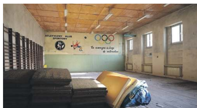
Ze względu na stan techniczny stara sala SOKÓŁ została wyłączona z użytkowania, a sam remont jest nieopłacalny.
