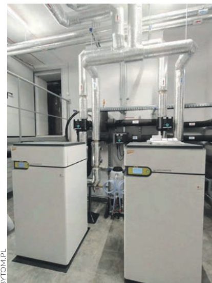
Nowoczesna instalacja w budynku przy ul. Huta Julia
