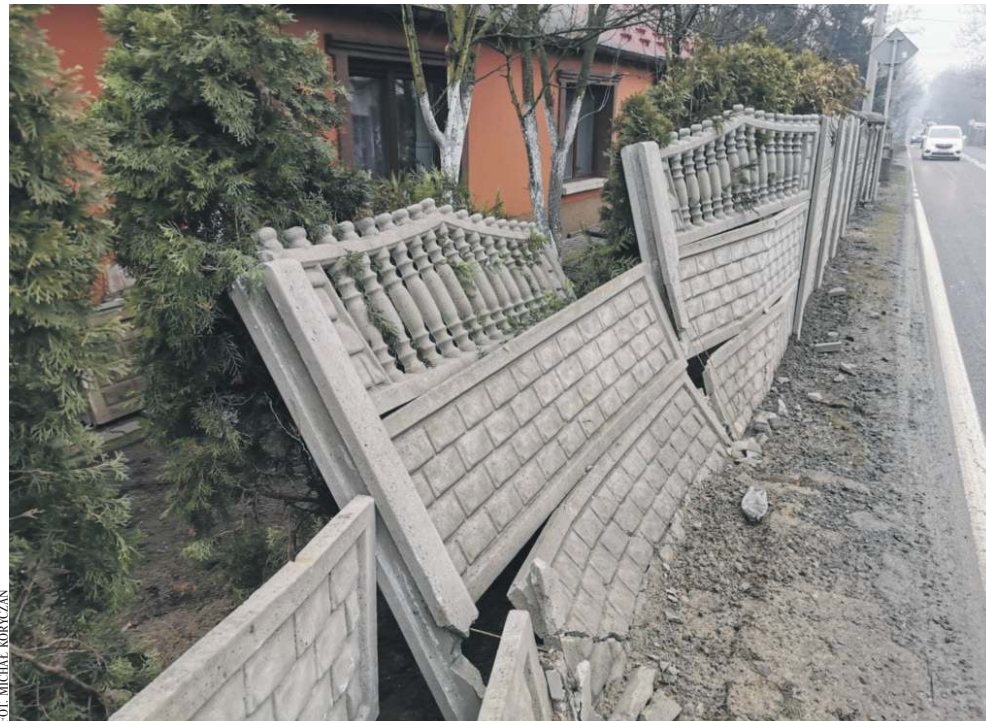
Zniszczone ogrodzenie posesji w rejonie zakrętu na ul. Wadowickiej w Jankowicach
