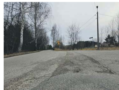
Skrzyżowanie ul. Obwodowej i Chechlanej w Żarkach, gdzie przewidziane jest pozimowe łatanie dziur
