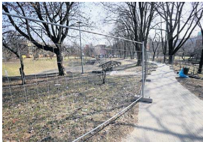
Amfiteatr na Tatarach powstał w połowie lat 70-tych ubiegłego wieku. Od lat podpadł w ruinę
