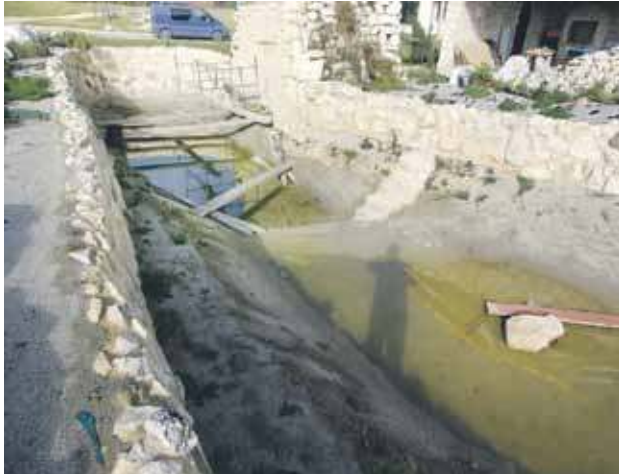
Właściciel wybudował niekę basenową, dokładnie w miejscu, gdzie metr pod ziemią przebiega rura gazociągu.
